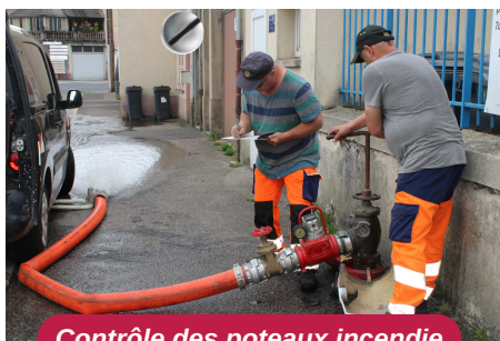
Contrôle des poteaux incendie
